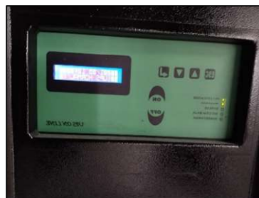
Ilustración 12 -UPS ATSEI 20KVA (3) GIT de Tecnología de la Información y las Comunicaciones
