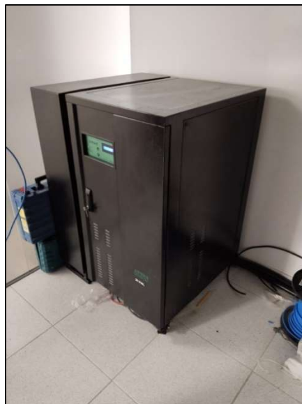
Ilustración 10 - UPS ATSEI 20KVA (1) GIT de Tecnología de la Información y las Comunicaciones
