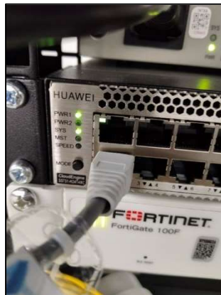
Ilustración 13 - demarcador Huawei CloudEngine S5731 GIT de Tecnología de la Información y las Comunicaciones
