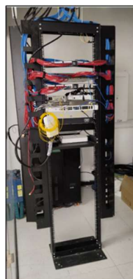
Ilustración 1- Rack Centro de Datos
