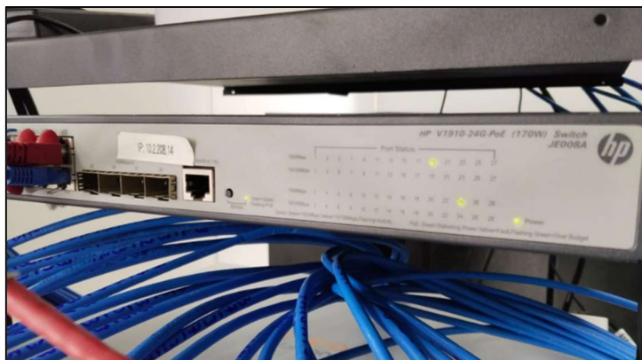
Ilustración 2- Switch HP JE008A – IP 192.168.57.241
