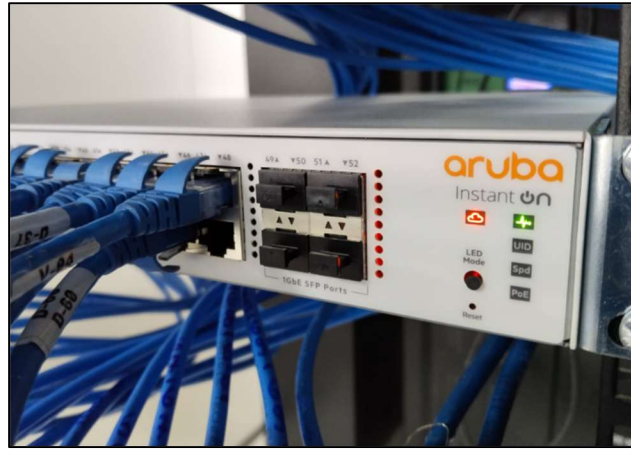
Ilustración 4 - Switch Aruba JL815-60001 - IP 192.168.57.3
